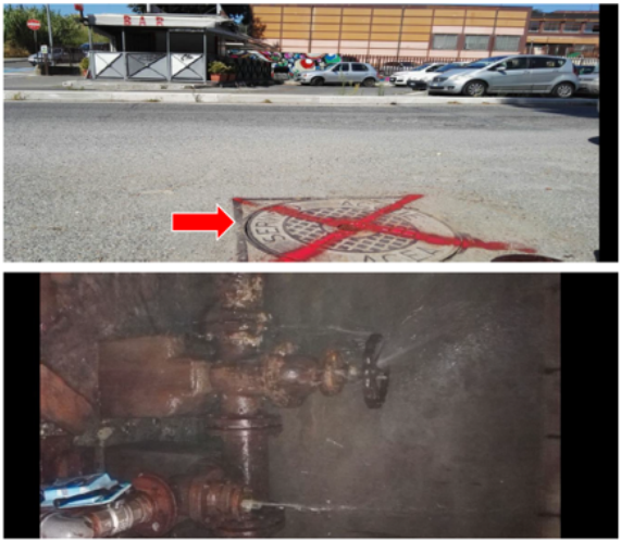
Pérdidas (en pozo) en Via Gregorio XI
