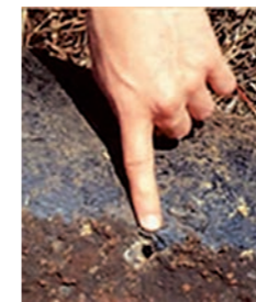
Perforation typique d'une canalisation mal isolée des courants vagabonds
